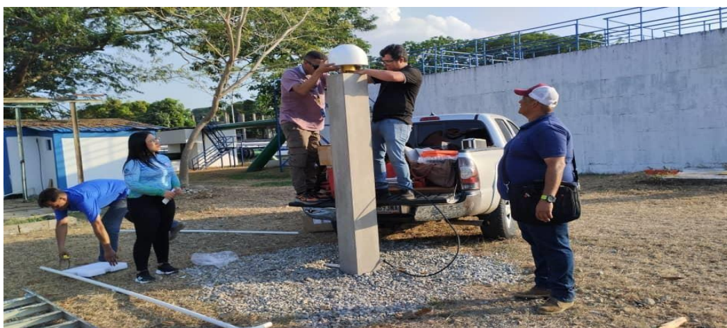
Figura 11. Colocación de la antena REMOS.
